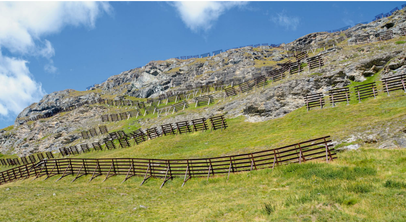
Stahlschneebrücken in einem Lawinenanbruchgebiet.
